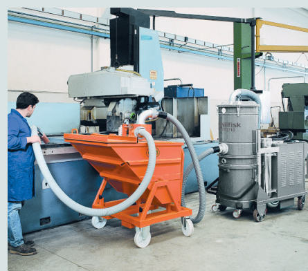
Industrie mécanique : récupération des copeaux et des huiles
